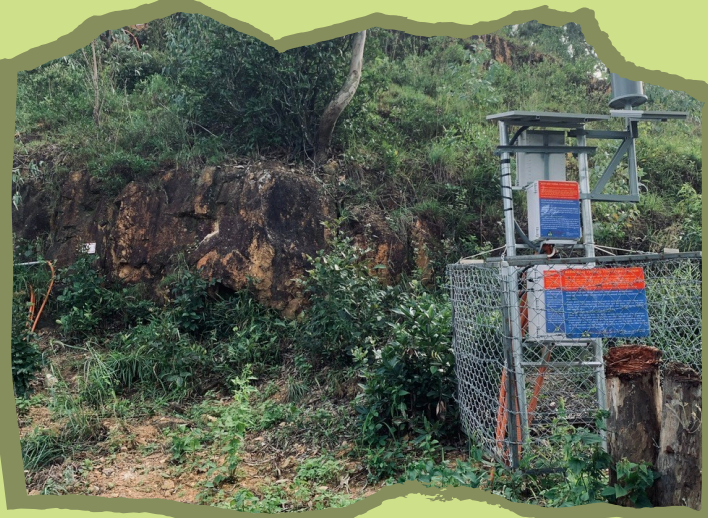
Trạm quan trắc ở núi Bà Hòa phường Quy Nhơn, tỉnh Gia Lai
